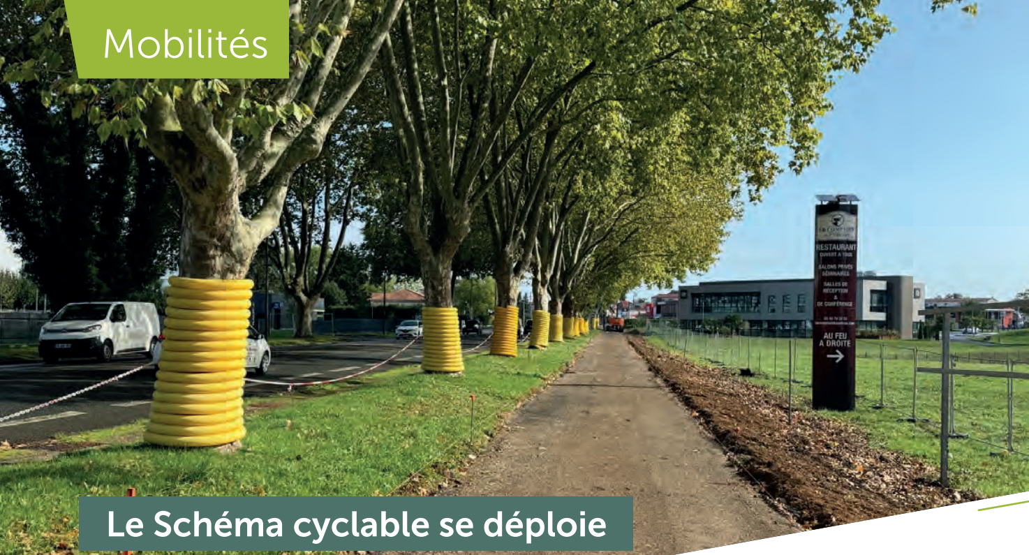
Voie cyclable en cours de réalisation sur l'avenue de La Rochelle à Niort. © Eric Chauvet
