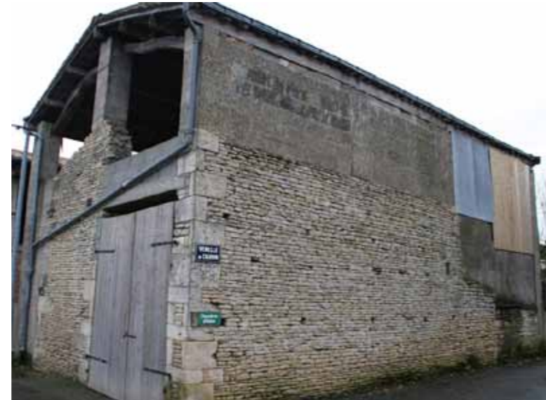
Bâtiment agricole de qualité à réhabiliter
